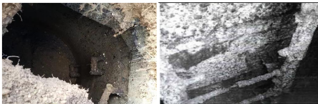
Рисунок 2 – Коррозия металлических элементов конструкций колодца канализации
