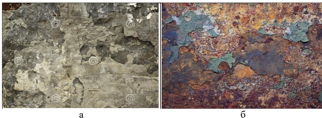
Рисунок 1 – Разрушение внешней стенки: а) бетонной конструкции; б) металлической конструкции
