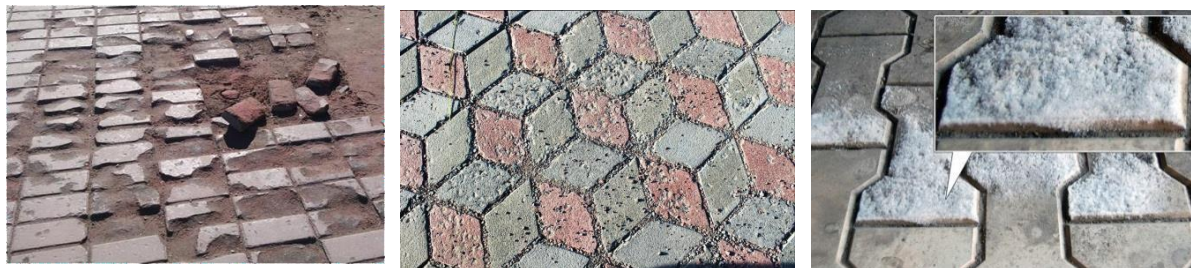
Рисунок 1 – Фрагменты разрушения тротуаров, устроенных из бетонных брусчаток
