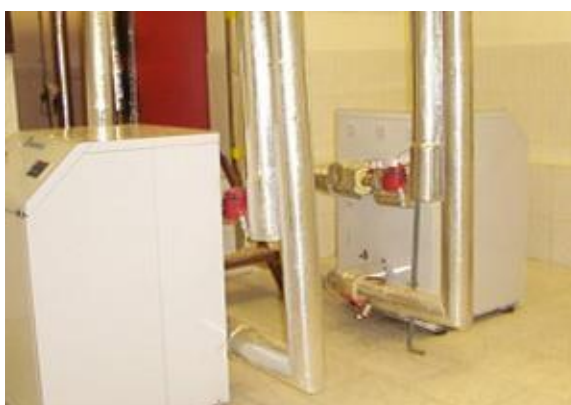
Рис. 5 – Теплоснабжающий тепловой узел. Тепловые насосы [5]
