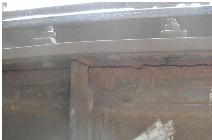
Рисунок 2 – Отрыв сварного шва, прикрепляющего стенку и вертикальное ребро жесткости к верхнему поясу подкрановой балки (материал авторов).
