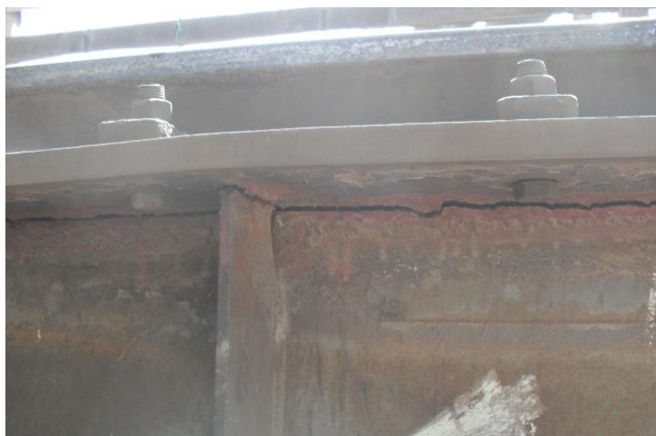
Рисунок 2 – Отрыв сварного шва, прикрепляющего стенку и вертикальное ребро жесткости к верхнему поясу подкрановой балки (материал авторов).
