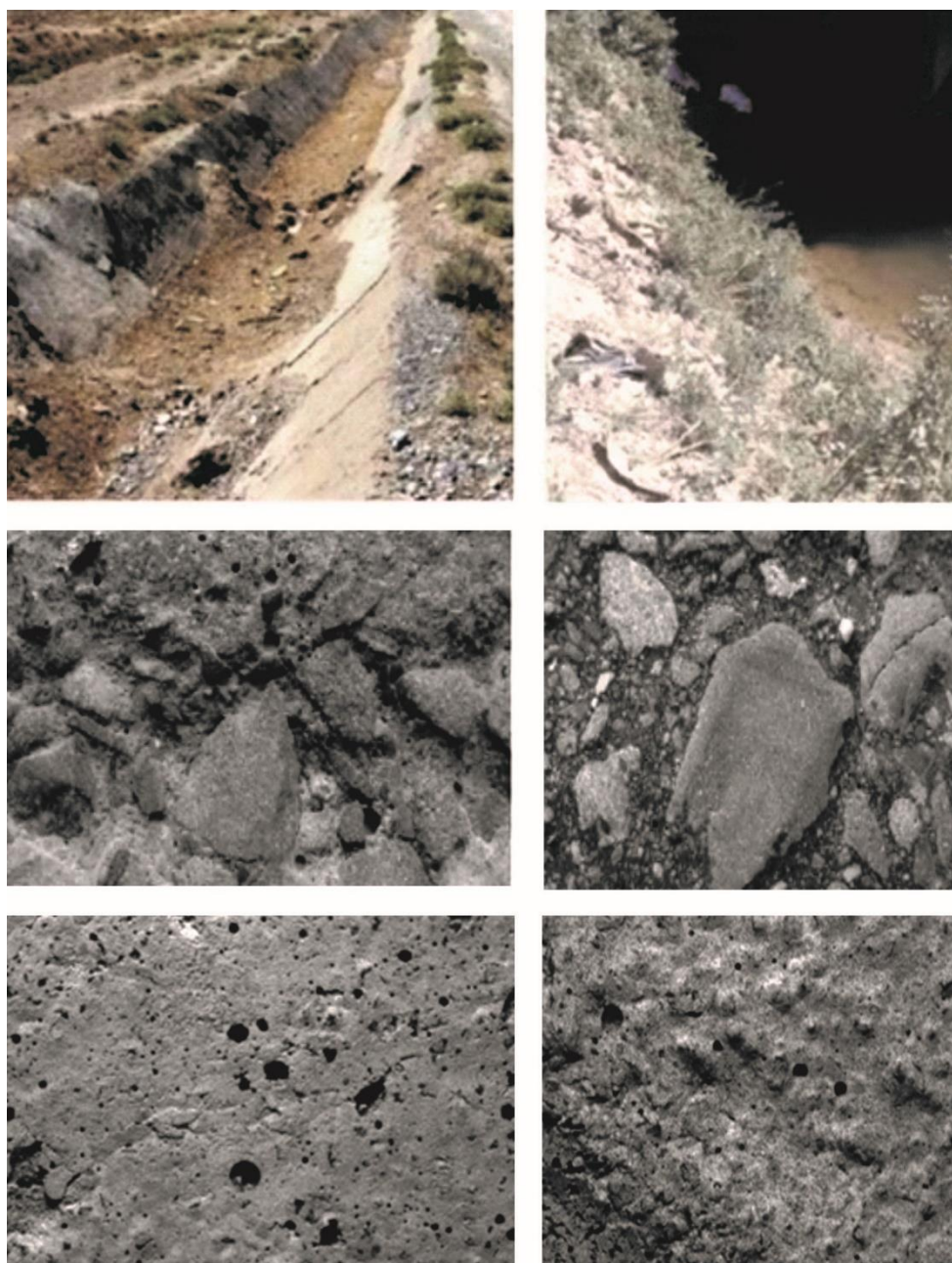
Рисунок 1 – Процесс истирания и абразивные повреждения поверхности гидротехнического бетона на оросительных каналах в предгорной зоне Туркестанской области [материал авторов]
