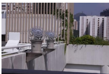
Вид на установленные на крыше гелиосистемы
