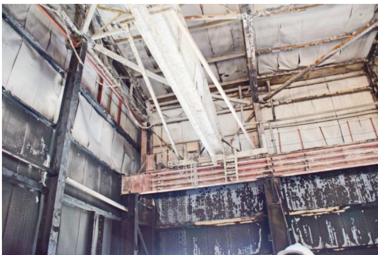
Рисунок 3 – Фахверковая колонна в оси 9-15/К. Искривление колонны
