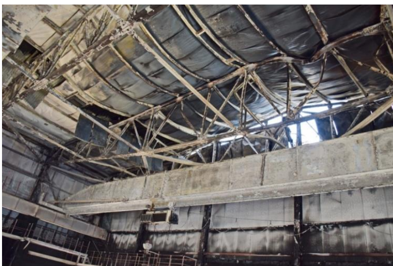
Рисунок 2 – Конструкции покрытия в осях 9-15/К-І. Недопустимые деформации верхних поясов ферм, прогонов, связей
