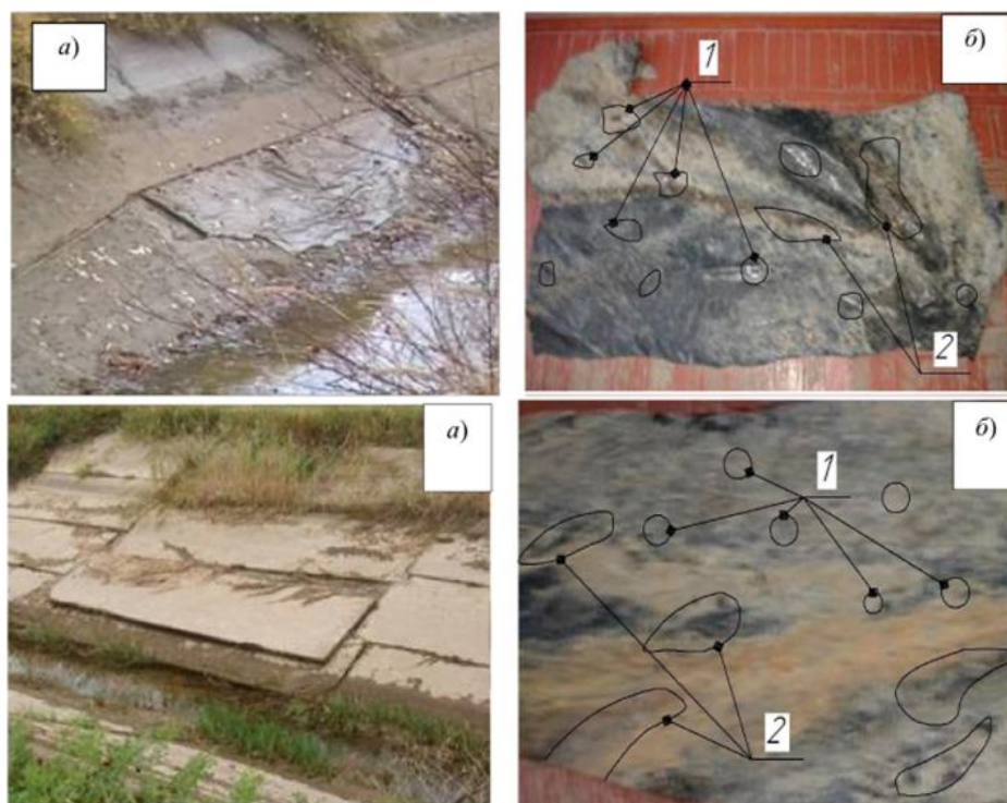
Рисунок 3 – Дефекты противофильтрационного элемента облицовки канала: а – откос канала; б – образец противофильтрационного элемента бетоноплочной облицовки: 1 – проколы; 2 – разрывы
